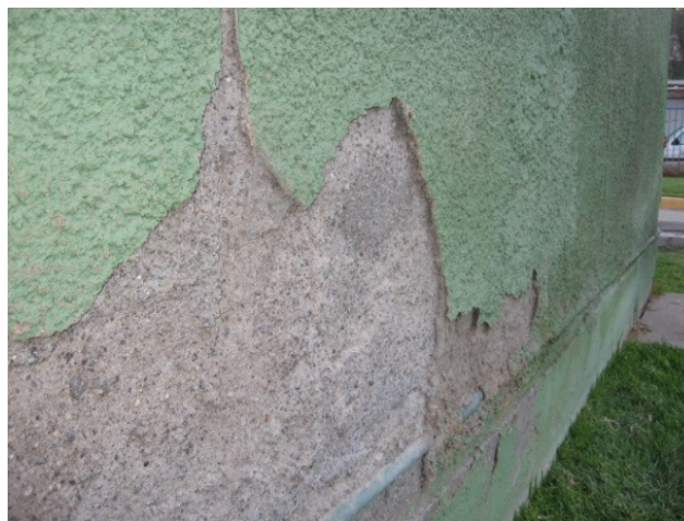
Salida del estuco externo es el problema causado por el exceso de humedad a las afueras del baño público
