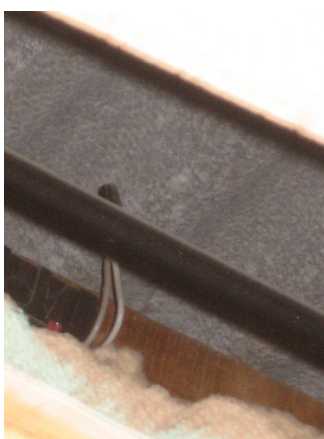
Imagen donde se aprecia las capas de la cubierta y material del techo
