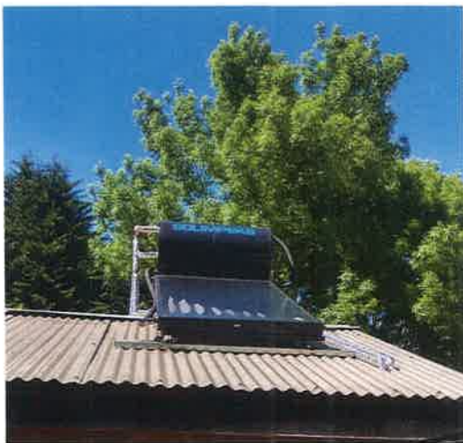
Imagen 8: Sistema solar térmico por termosifón instalado en techo
