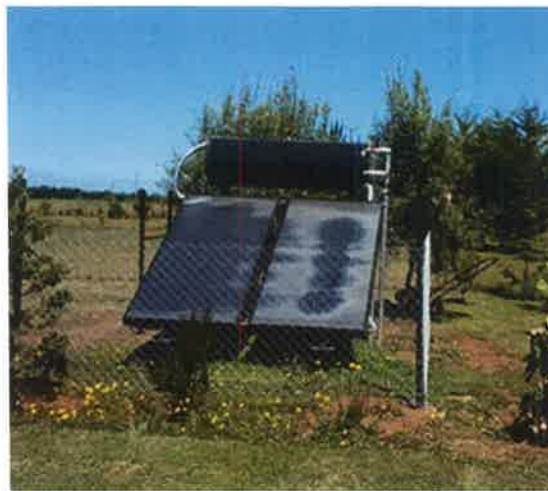
Imagen 9: Sistema solar térmico por termosifón instalado a piso
